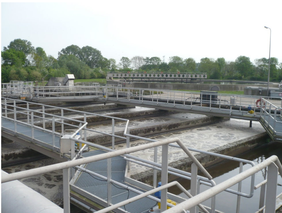
Figuur 4 Rioolwaterzuiveringsinstallatie (rwzi)
